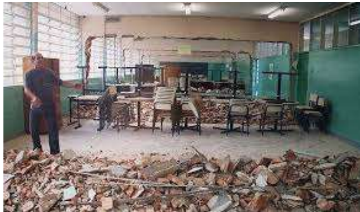
Imagem 3 – O diretor B.N. e a foto registro da derrubada de paredes e formação dos salões de estudo – EMEF Campos Salles
